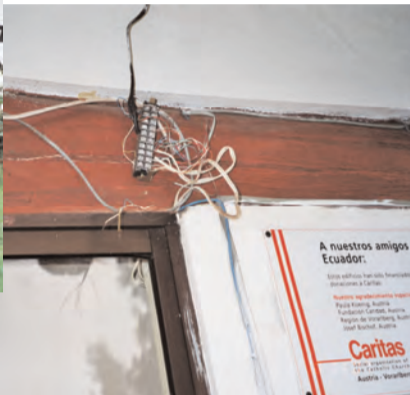
Auffällig desolote Elektroinstallation
